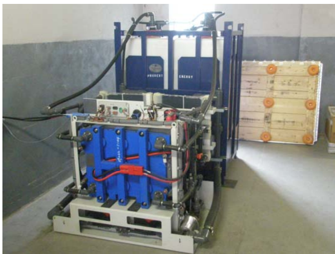
Vanádium – Redox tároló 5 kWp 20kWh teljesítménnyel Szentesen
