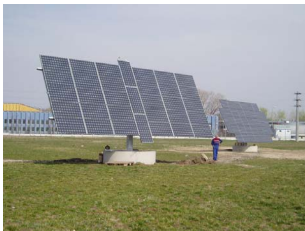
Tesco Logisztikai Központ; Gyál 20,75 kWp
