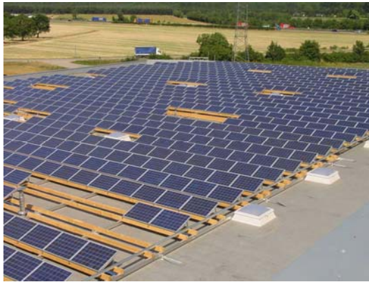
Malsch, Németország 520 kWp
