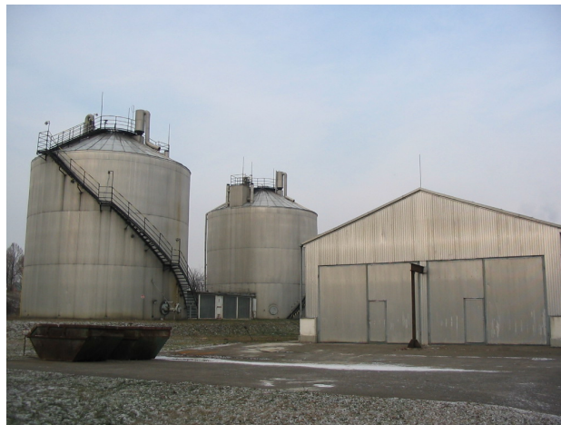
Szennyvíztelep biogáz hasznosítás
